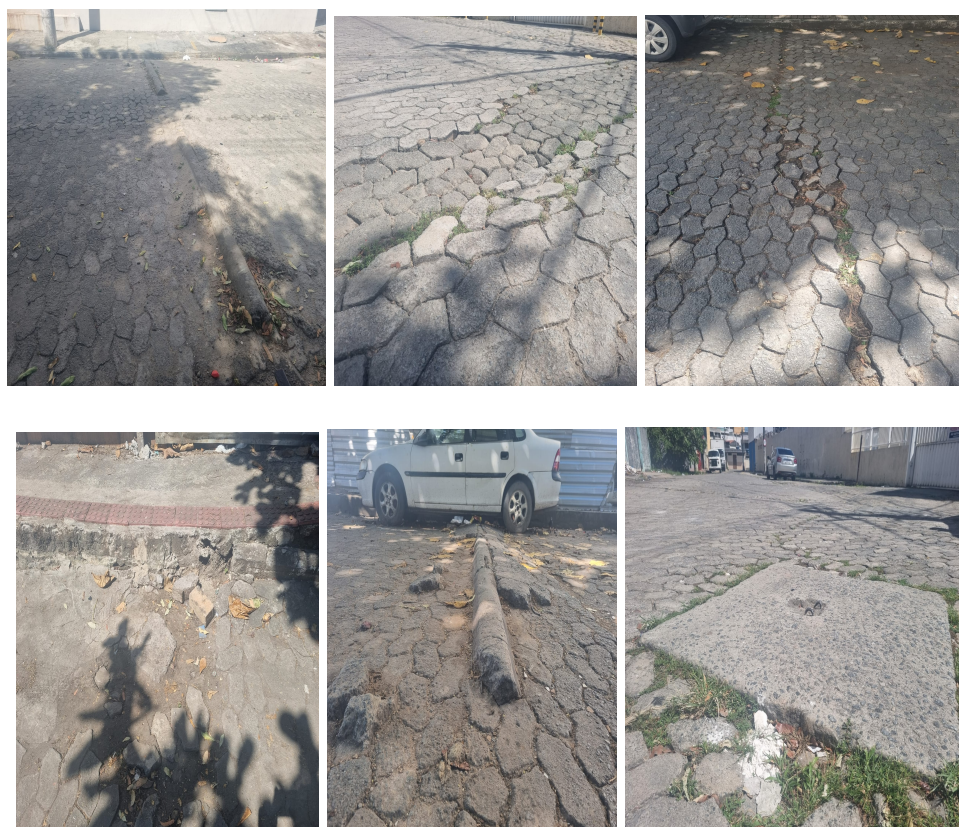
SITUAÇÃO DA RUA AREIA BRANCA NO BAIRRO ITAPUÃ.
