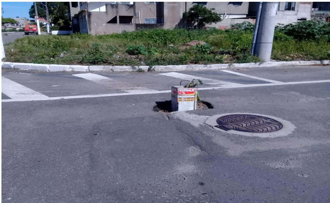
Buraco na Rua Cedrolândia (esquina da Praça Cristalina)
