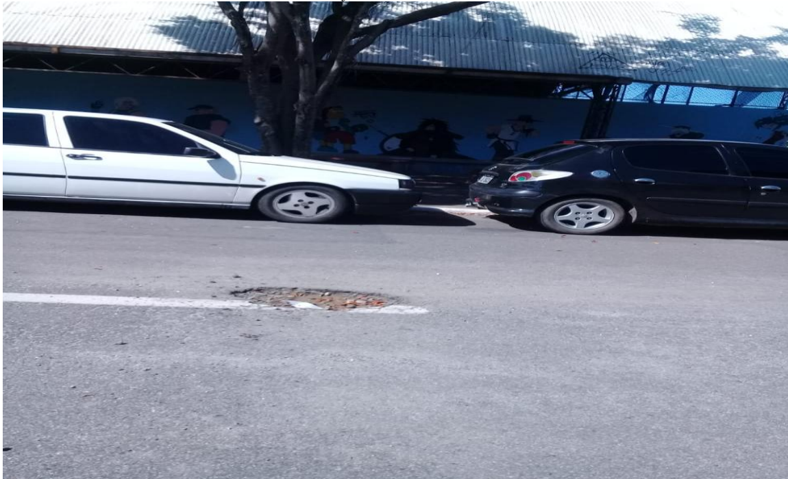
Buraco na Rua Cedrolândia (nos fundos da Quadra da Praça Cristalina)
