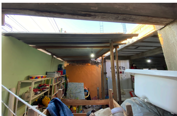
Antes — partes sem teto, chuva caindo dentro
